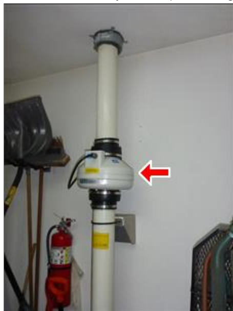
14.12 Picture 1 Radon Fan
